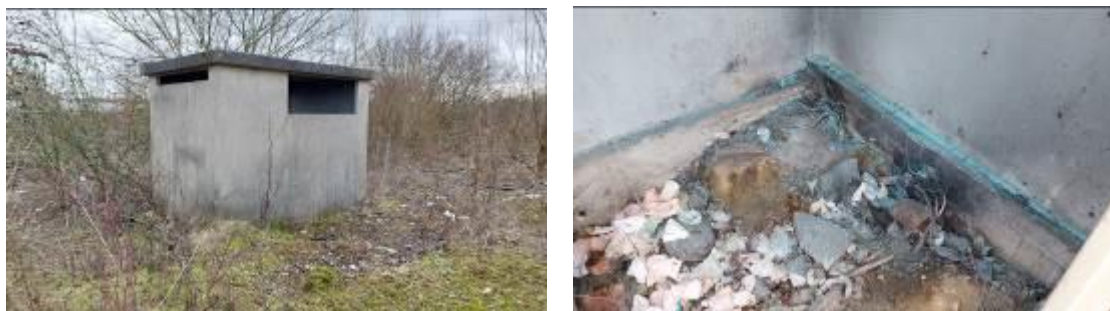
Illustration n° 10 : Ancien transformateur (source : EACM, février 2023)
